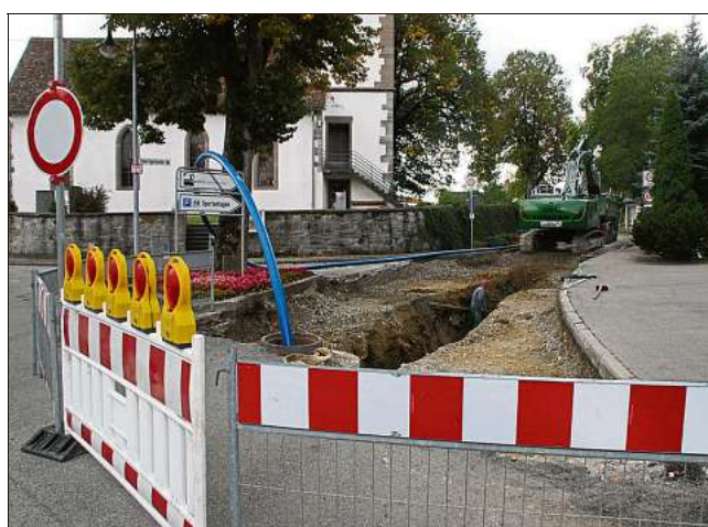
Neue Leitungen werden bis Anfang November in der Britzheimer Turmstraße verlegt. Foto: Hertle
